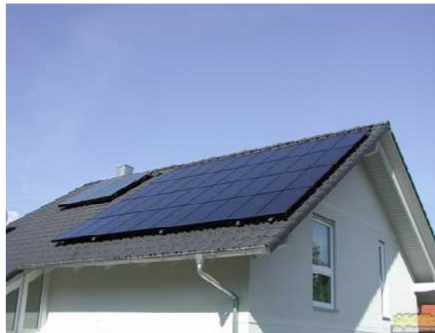
太阳能光伏系统
